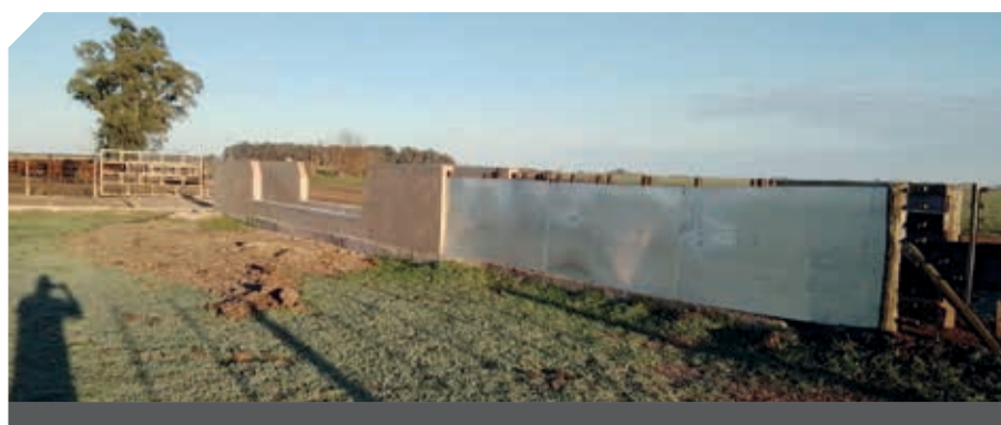
La construcción de un bañadero sobre una manga preexistente cuesta alrededor de U$S 10.000.
